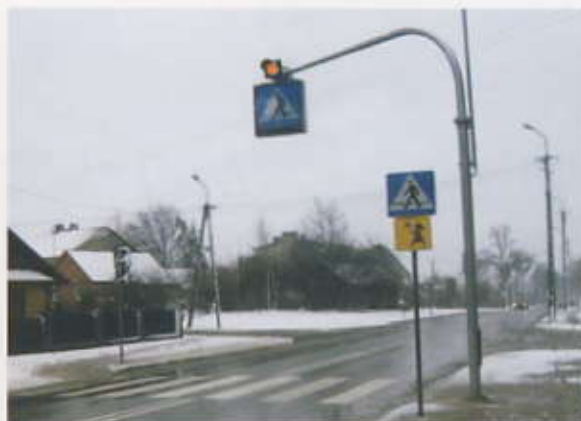
Pulsator nad przejściem dla pieszych.
