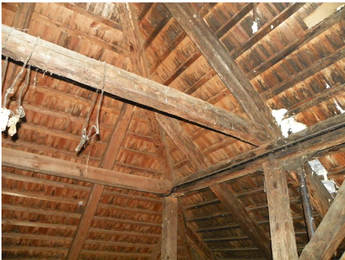
Foto2. Konstrukcja dachu – widoczne koroze
