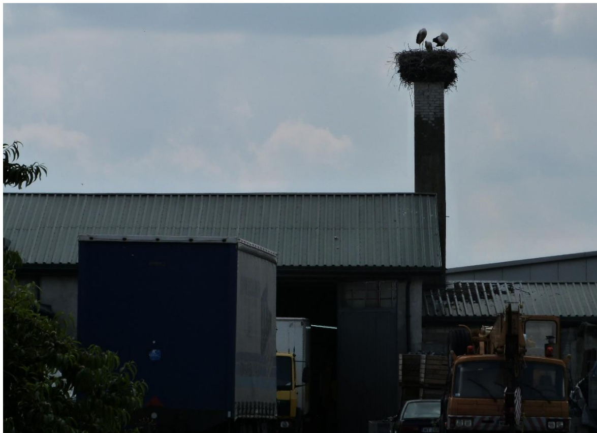
Fot. 27. Gniazdo na kominie o wysokości ponad 2 m, znajdującym się na budynku przemysłowym, pokrytym blachą – K2BPP.
