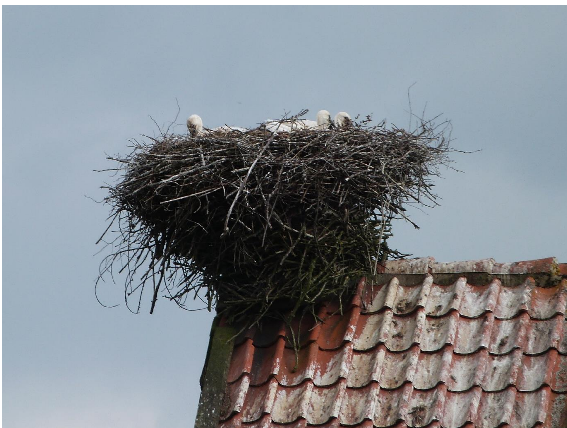
Fot. 36. Gniazdo zagrożone osunięciem ze względu na niestabilną, zbyt wąską podstawę gniazda.
