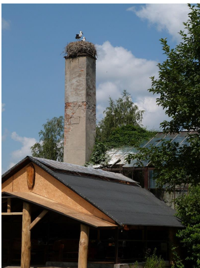
Fot. 28. Gniazdo posadowione na kominie wolnostojącym o wysokości ponad 2 m – KW.
