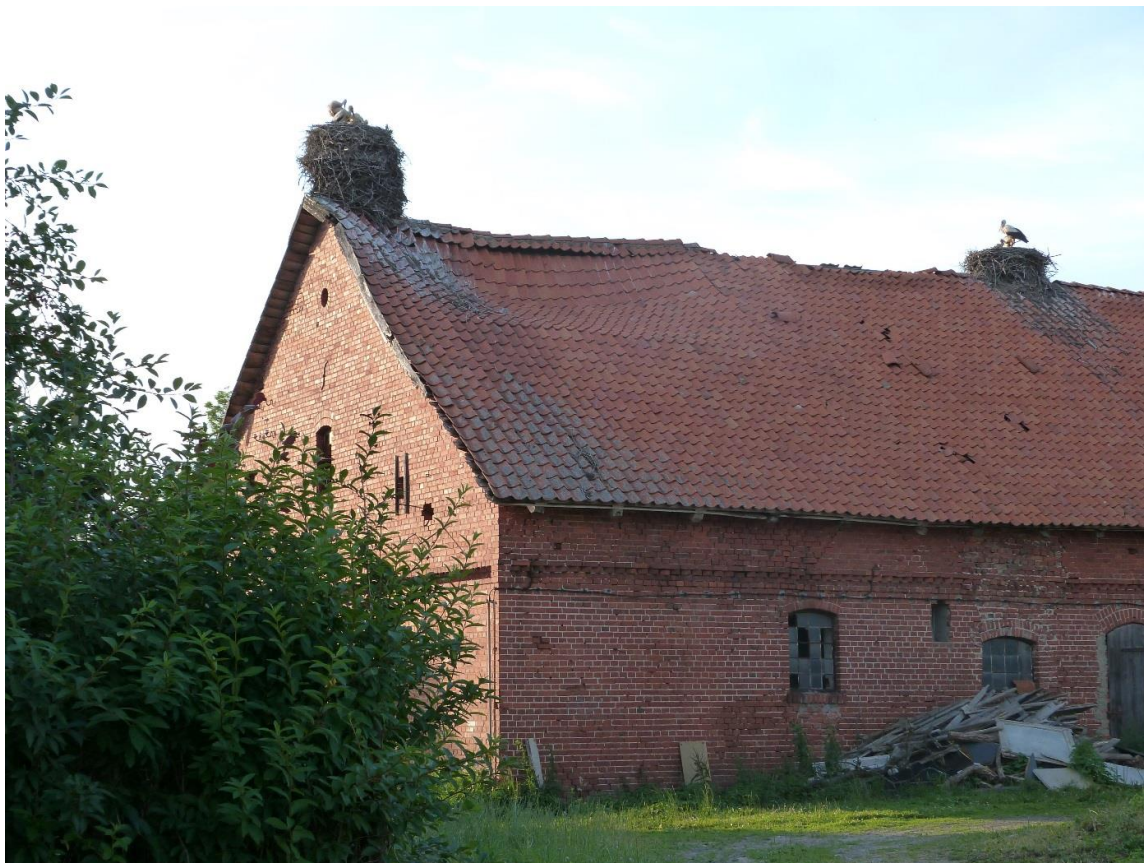
Fot. 35. Gniazdo posadowione na krańcu budynku zagrożone osunięciem z uwagi na uginający się dach obory.
