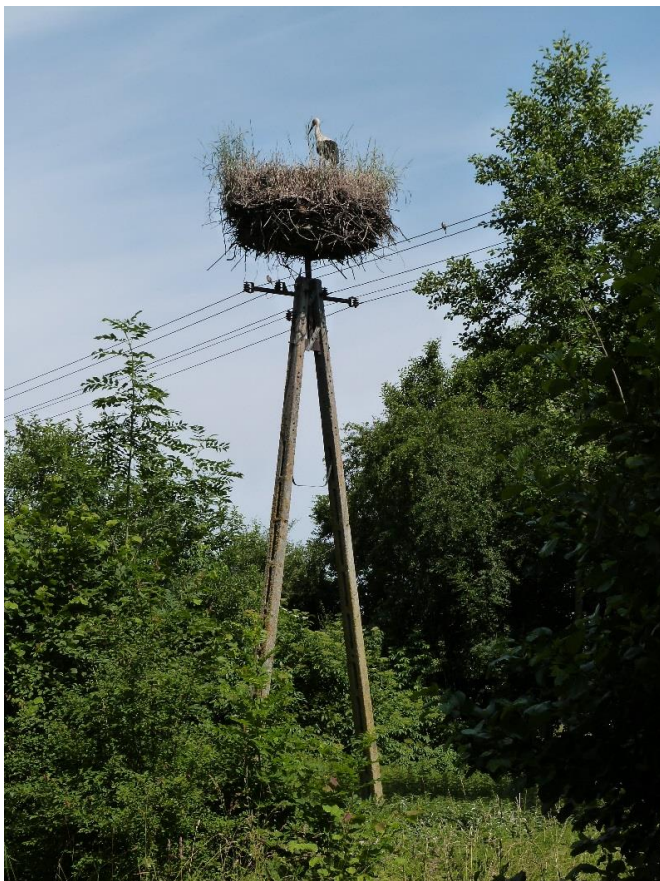
Fot. 11. Gniazdo na słupie energetycznym podłączonym do sieci betonowym typu A – SEBA.
