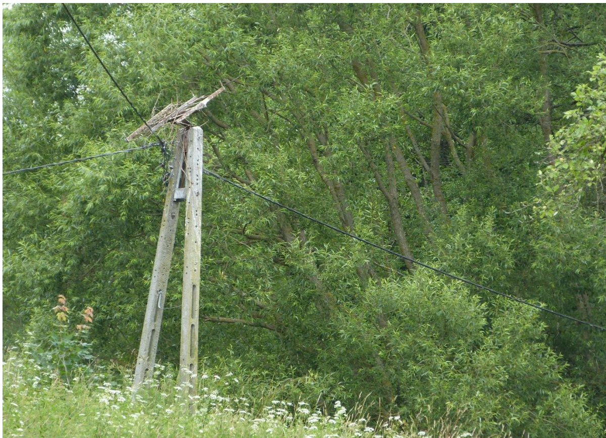
Fot. 37. Metalowa platforma przekrzywiona pod wpływem ciężaru gniazda – gniazdo spadło.
