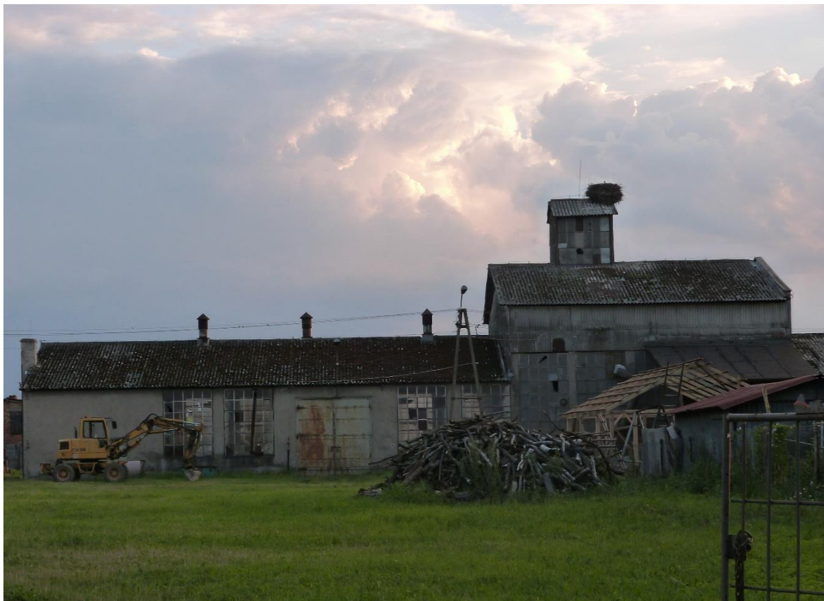
Fot. 25. Gniazdo na budynku gospodarczym o nieokreślonym przeznaczeniu, pokrytym eternitem – BGE.
