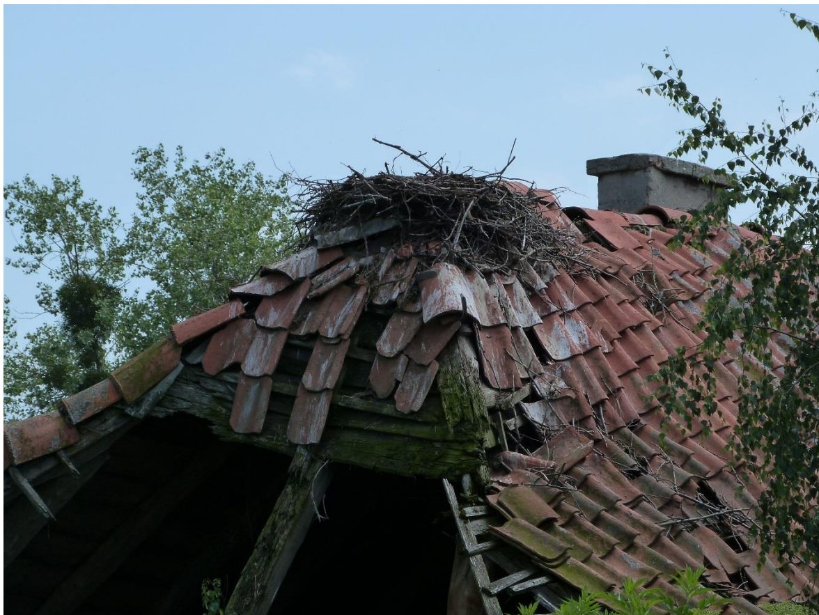
Fot. 31. Bocianie gniazdo posadowione na dachu budynku grożącym zawaleniem.
