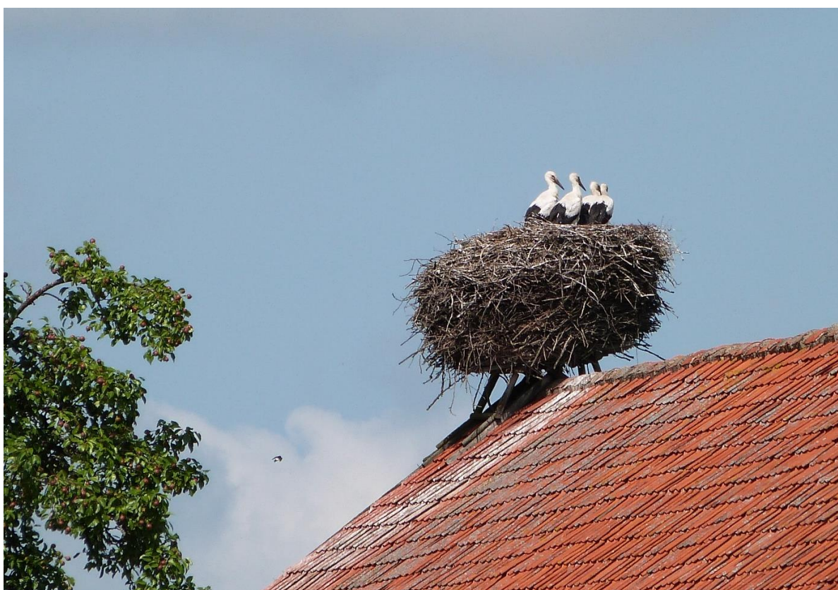
Fot. 34. Gniazdo zagrożone osunięciem z uwagi na przekrzywioną, prawdopodobnie pod wpływem dużego ciężaru gniazda, drewnianą platformę.
