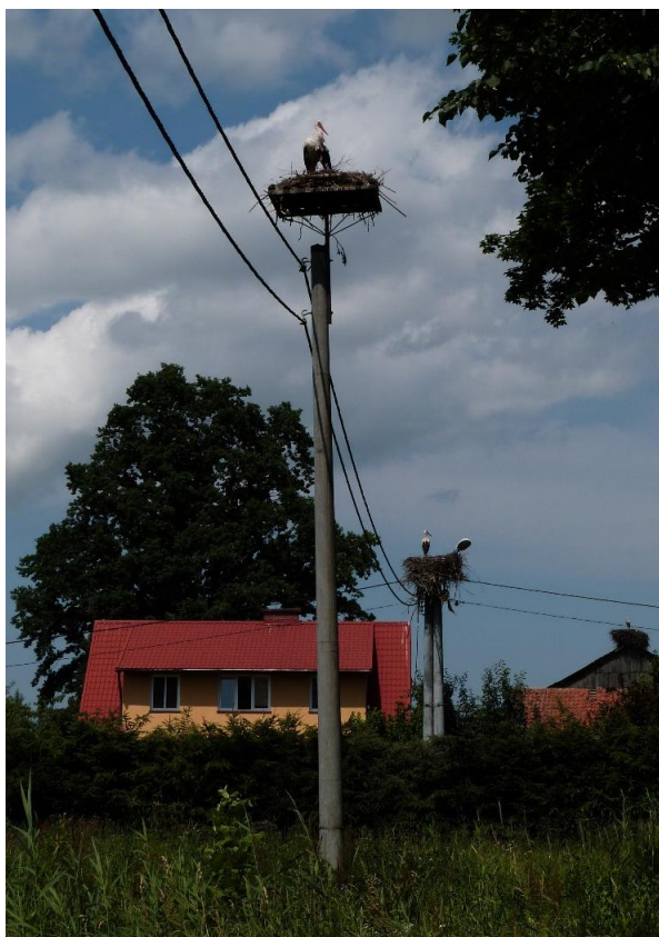
Fot. 16. Gniazdo na słupie energetycznym podłączonym do sieci betonowym okrągłym – SEBO.
